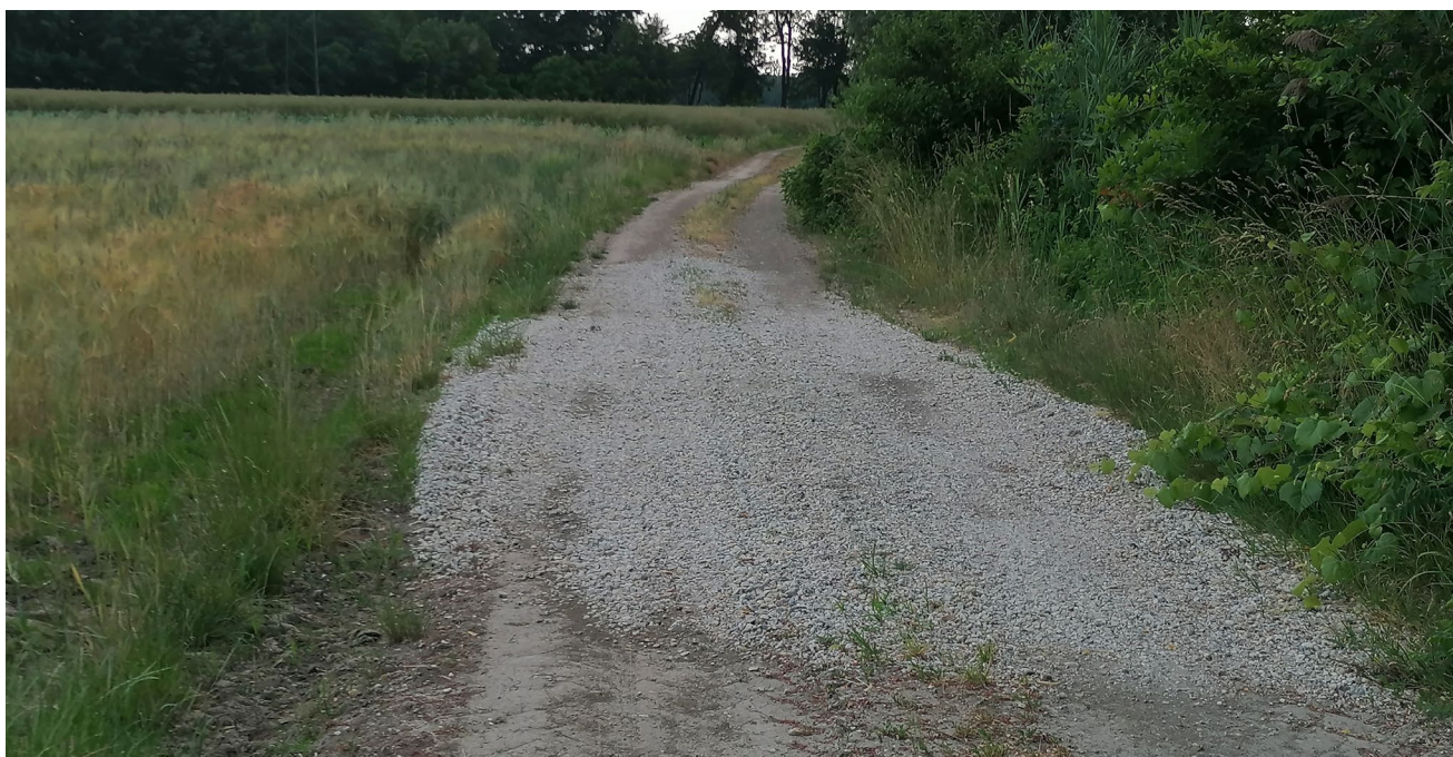
Slika 176. Zasutje dela ceste, kjer se je pojavil udar zaradi bobrove dejavnosti.
