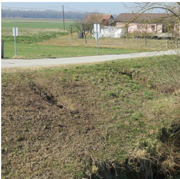
Slika 169. Udori brežine vodotoka ob cesti.
