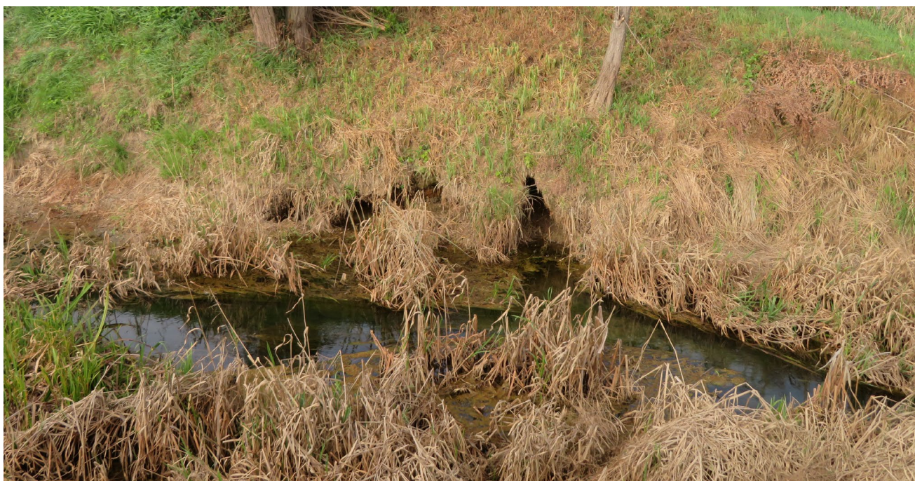
Slika 40. Izkopani brlogi v brežino vodotoka.
