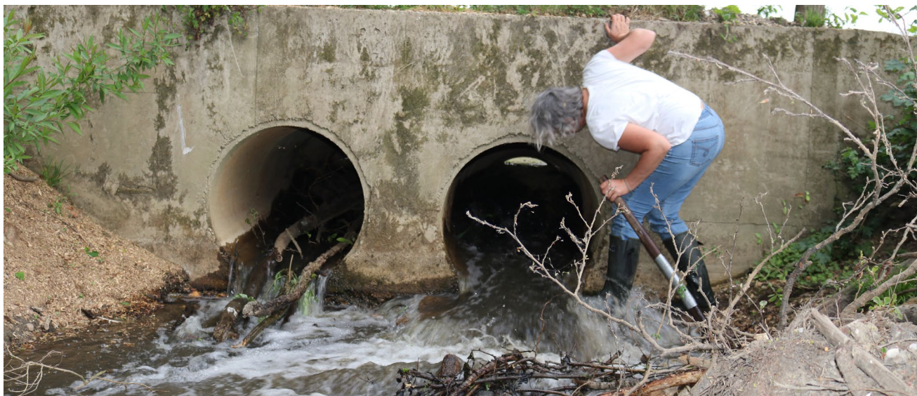
Slika 109. Zamašen cevni prepust.
